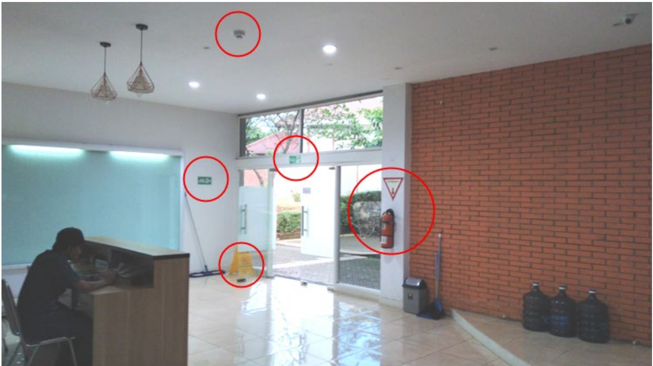
Tanda jalur evakuasi, APAR, smoke detector , dan rambu-rambu
