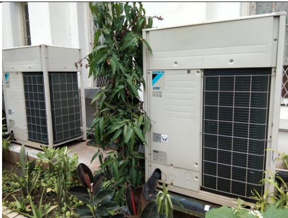
AC VRV untuk menyuplai Laboratorium Departemen Biologi
