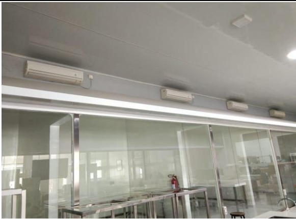
AC Split Inverter di Lab Parasitologi
