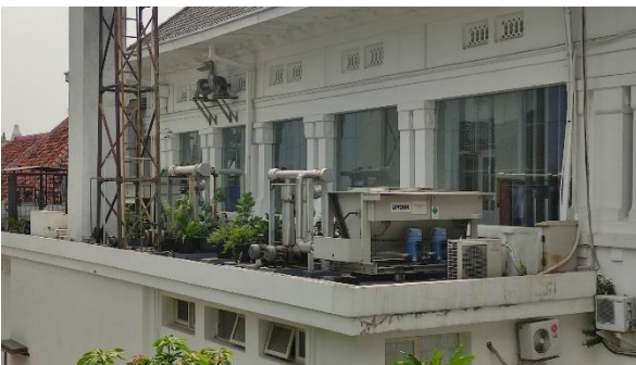
Chiller di Laboratorium Terpadu dan Departemen Fisiologi
