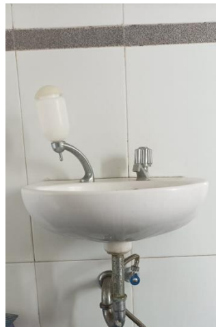
Kran wastafel konvensional sebelum di ganti.
