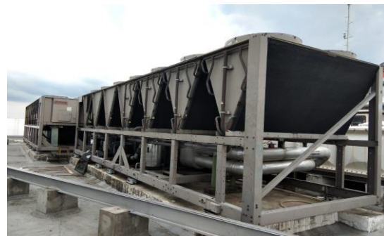
Chiller gedung IMERI yang menggunakan kondensor michrochannel yang bisa menghemat energi listrik sbesar 30 – 40 % dari chiller konvensional.
