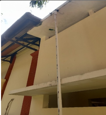
Jalur pipa untuk memanen air hujan ( Rain harvesting )
