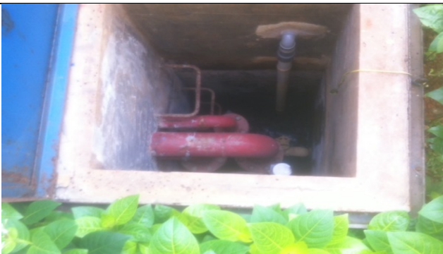
Penggunaan kran otomatis pada ground tank air PDAM
